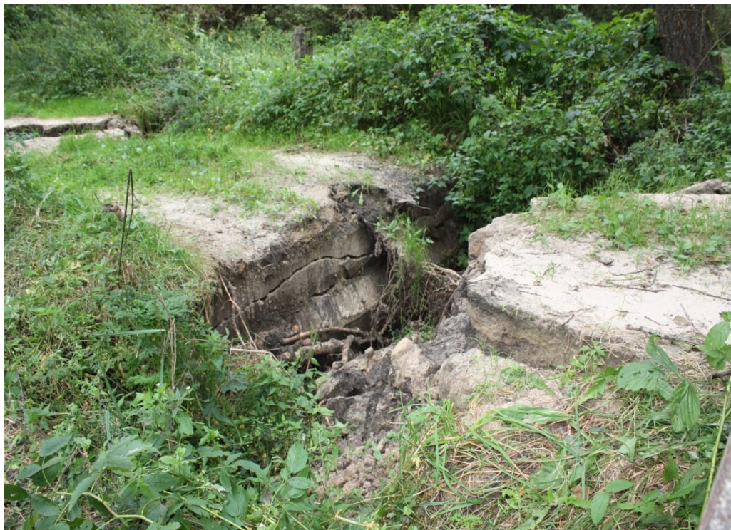
FOT. 4 Uszkodzenie drogi gruntowej na terenie nadl. Narol
