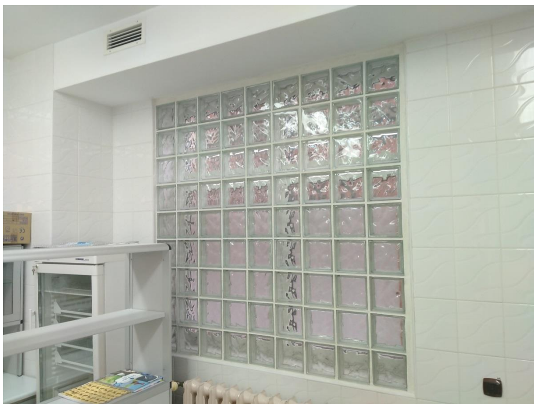
Zdjęcie 4.2-1 Okno wykonane z luksferów na potrzeby systemu przeciwpożarowego
